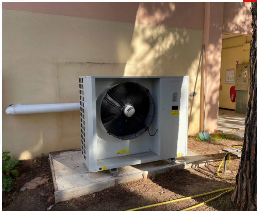
Fig.2 : PAC Effipac 26 adossée à la chaufferie de l'école
