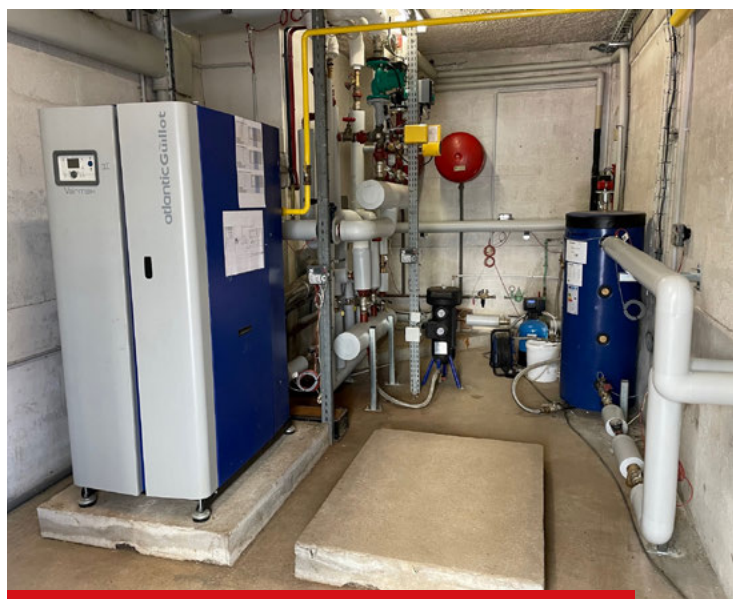
Fig.1 : chaufferie de l'école Debussy (à droite les tuyaux provenant de la PAC)
